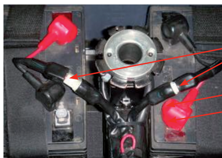
Morsetti della batteria
